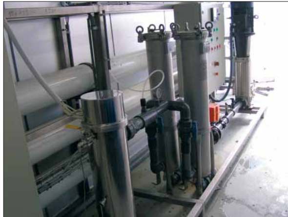
Figuur 12-2. Overzicht van een deel van de installatie bij Olympia: UV-filter (vooraan), kaarsenfilters (midden) en membraanmodules (achtergrond)bron.
